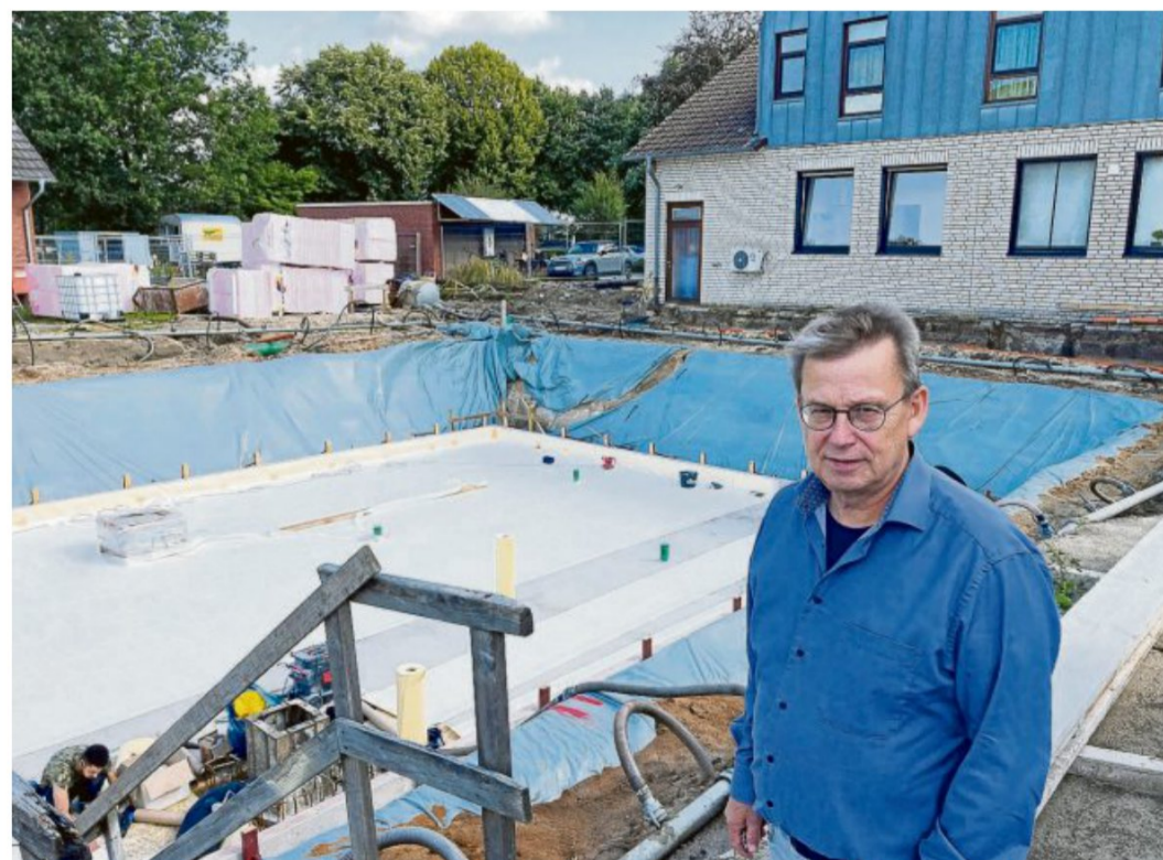
Nur fürs Foto rund um die große Baugrube: Johannes Dierker, Geschäftsführer der Jugendbildungsstätte, hat das gerne gemacht. Ein feines Lächeln auf dem Gesicht zeigt, wie sehr er sich freut, dass nach vielen Jahren voller Ideen und Pläne nun endlich Bagger und Handwerker aus Träumen Realität machen. Foto: Peter Henrichmann-Roock
